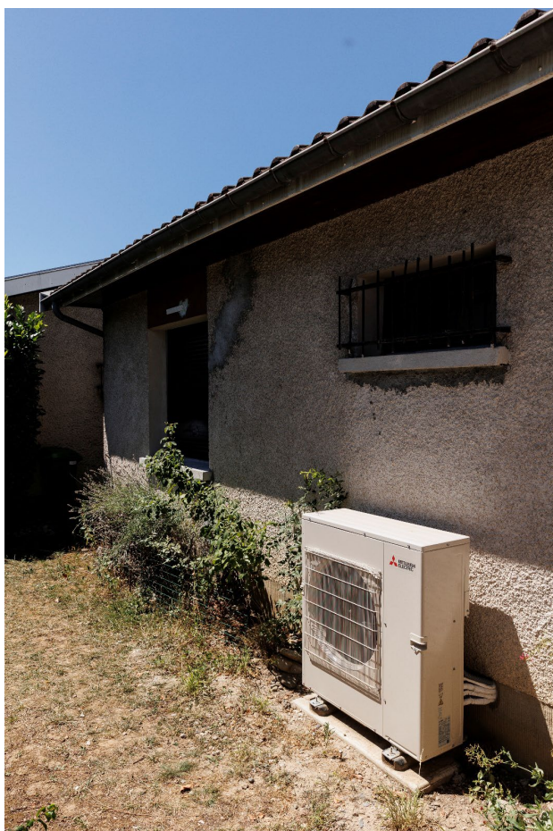
— Intégration de la PAC air/air à l'arrière de la maison
