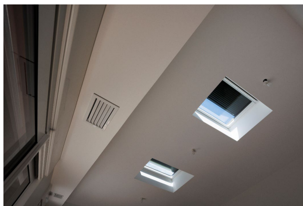
— Grilles pour la distribution de la chaleur de la PAC air/air
