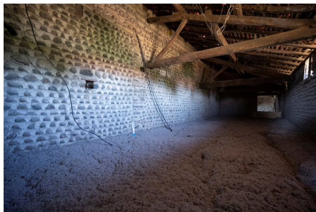
— Isolation des combles perdus ventilés
