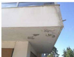
Mauvaise étanchéité des balcons
